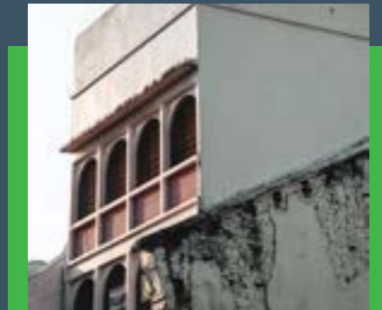
Évaluation des dommages
