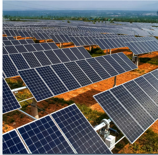
3亿瓦特太阳能光伏发电项目
